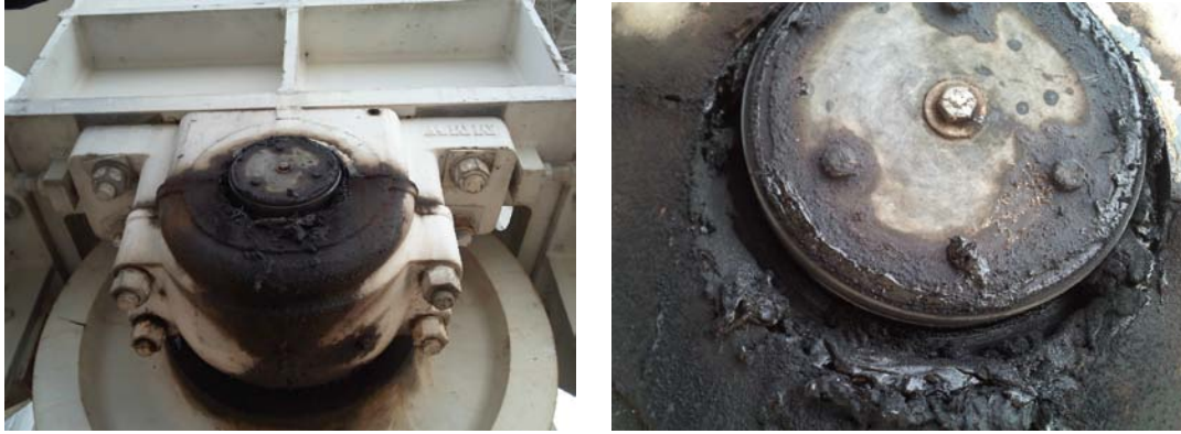
Fig. 4 - Stato della ruota coinvolta nel guasto
