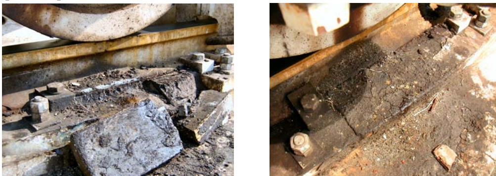
Fig. 2.a , 2.b - Stato del grout preesistente
